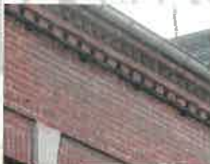
Gouttière pendante devant corniche.
