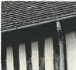
Gouttière pendante sur toiture débordante.
